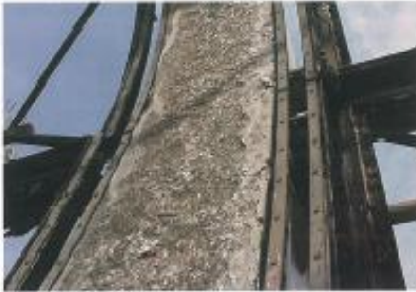
Figuur 2.14 Afgespat beton.
